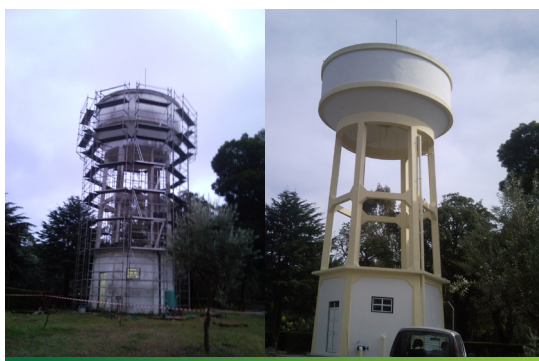
Reabilitação exterior e interior dos reservatórios elevados, reforço da adução e instalação de sistemas de tratamento - Escola de Fuzileiros Navais, Barreiro
