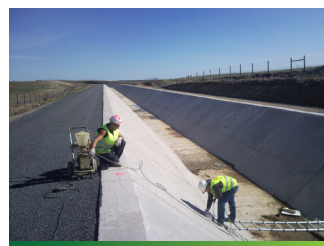
Canais do Sistema de Rega de Fins Múltiplos de Alqueva
