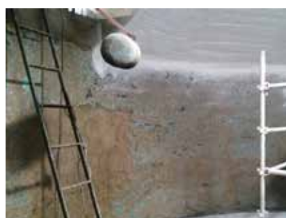
Tratamento do betão e impermeabilização de reservatórios de água em Arcos/Granja, e reservatório de Antas - Penedono (2016).
