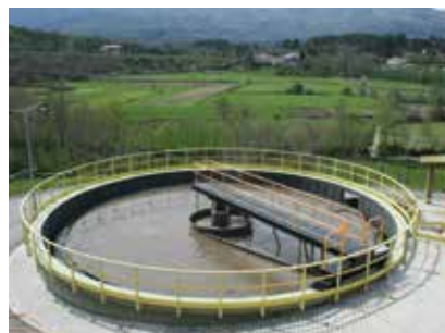
Estação de tratamento de águas residuais.
