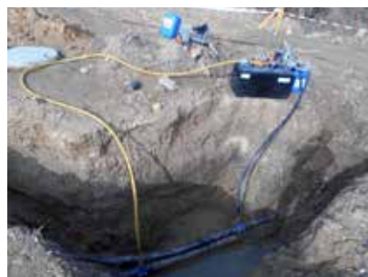
O desinfetante utilizado para desinfecção de conduitas é o ALBILEX® SUPER-des, composto em 50 % por peróxido de hidrogénio.
