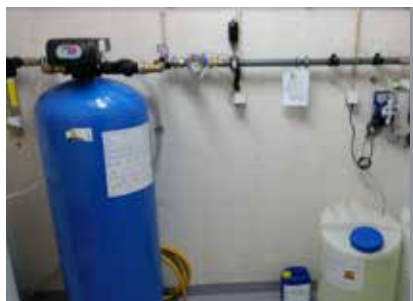
Sistema de tratamento de água potável, composto por tratamento bacteriológico, correcção de pH e desnitrificação, Provincia Portuguesa das irmãs de S. José de Cluny - Braga.
